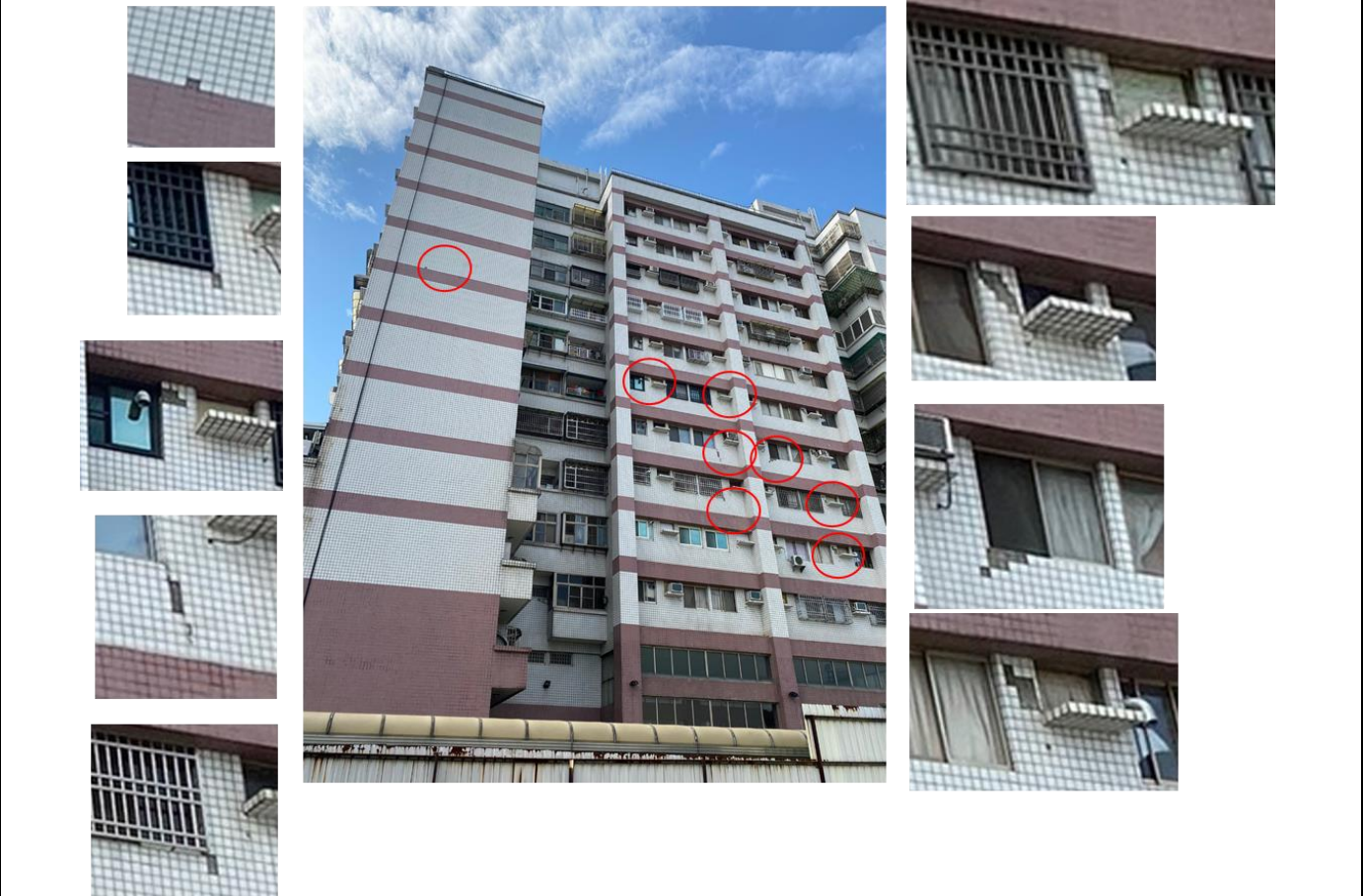
東側立面(窗框角隅有 45 度角裂痕)
