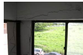
梯廳樑柱龜裂
