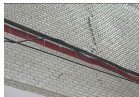
外牆立面龜裂
