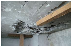
天花板鋼筋外露
