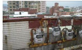
屋頂瓦斯表及管線
