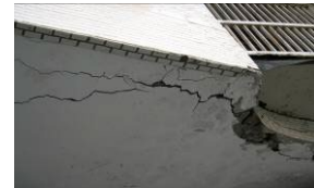
外牆鋼筋外露
