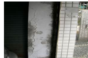
地下室柱爆裂
